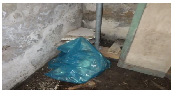
Foto 26 | Foto voor bron restanten vlakke plaat
